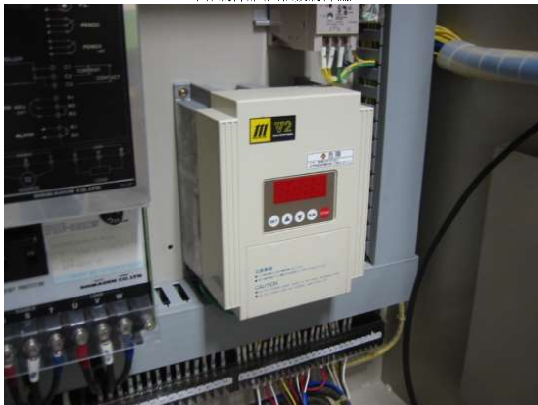
本体制御部(回転数制御盤)
