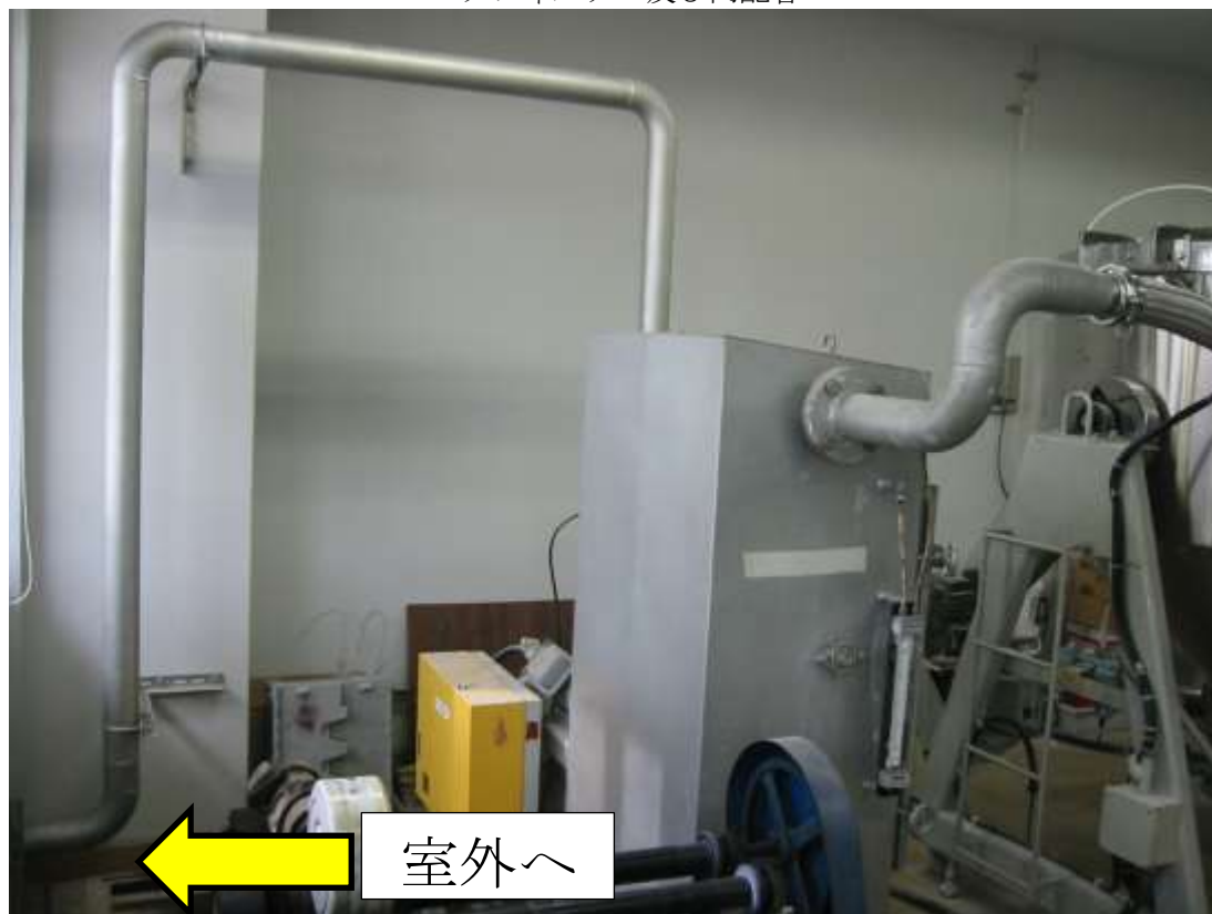
バグフィルター及び同配管
