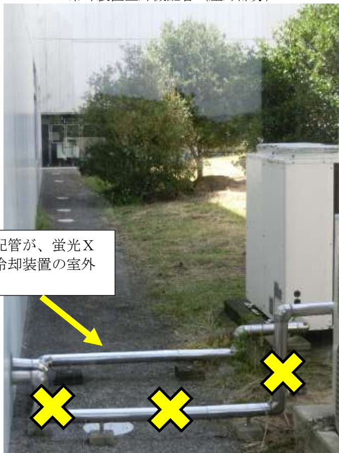
冷却装置室外機配管 (屋外部分)
