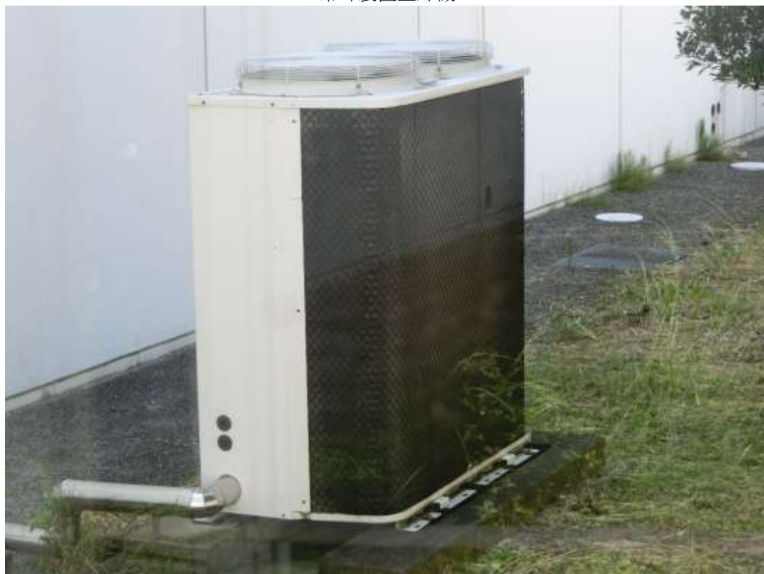
冷却装置室外機
