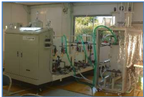
濃度差水素製造システム
